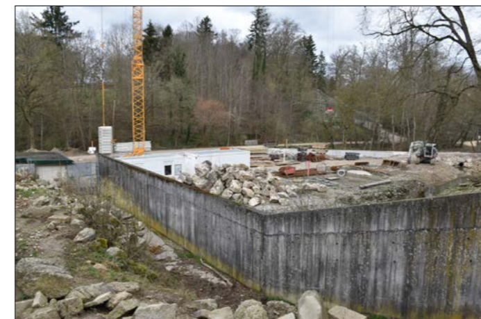
Derzeit noch eine Großbaustelle: im Herbst soll die neue Bären- und Wolfsanlage feierlich eröffnet werden. Fotos: Stoschek
